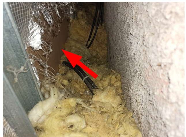
foto/24/ Pohled na poškozenou parozábranu v místě sondy S1, patrně vlivem působení živočichů
