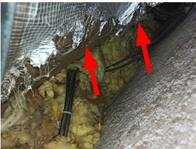
foto/23/ Pohled na poškozenou parozábranu v místě sondy S1, patrně vlivem působení živočichů
