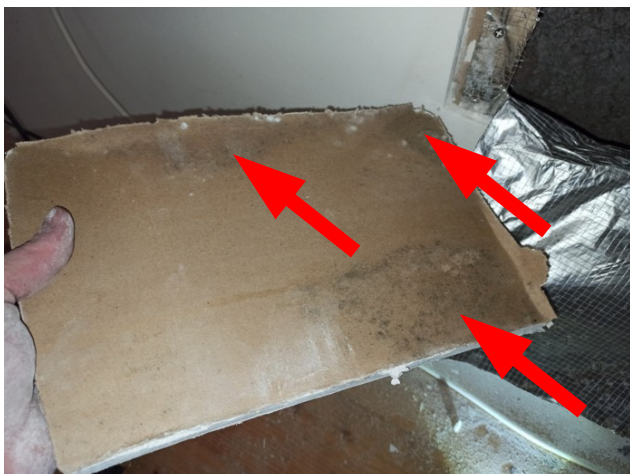
foto/27/ Pohled na SDK desku napadenou plísní z exteriérové strany
