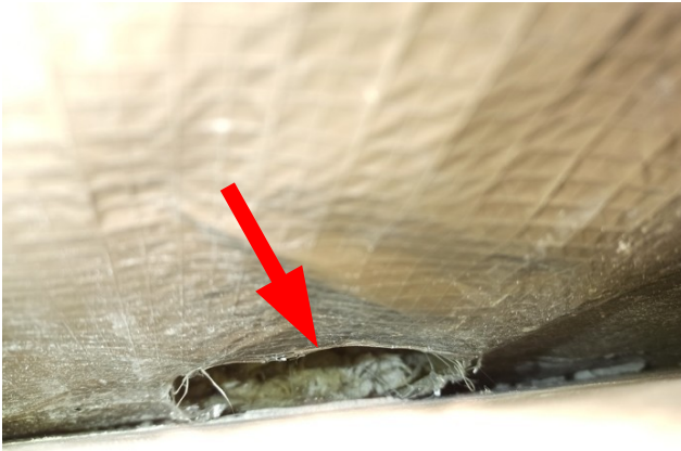
foto/21/ Pohled na poškozenou parozábranu v místě sondy S1, patrně vlivem působení živočichů
