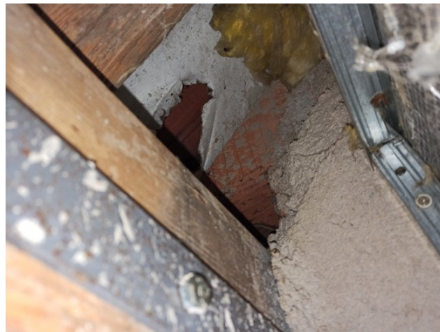
foto/26/ Pohled do dutiny za SDK předstěnou – patrná střešní taška skrz poškozenou DHV
