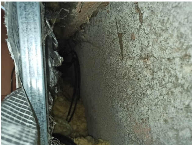
foto/25/ Pohled do dutiny za SDK předstěnou – tepelná izolace pouze v úrovni podlahy
