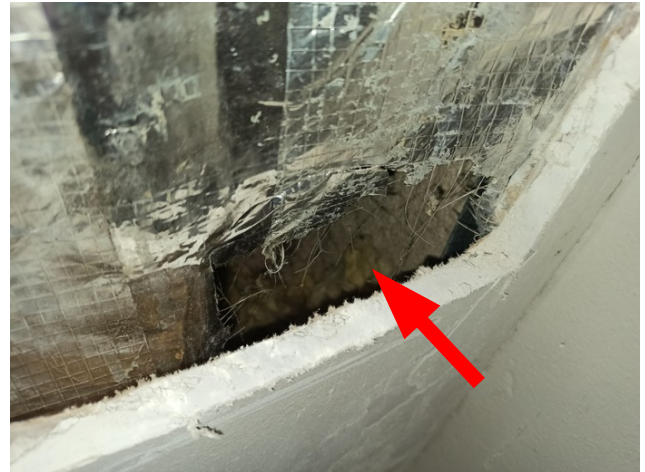
foto/22/ Pohled na poškozenou parozábranu v místě sondy S1, patrně vlivem působení živočichů
