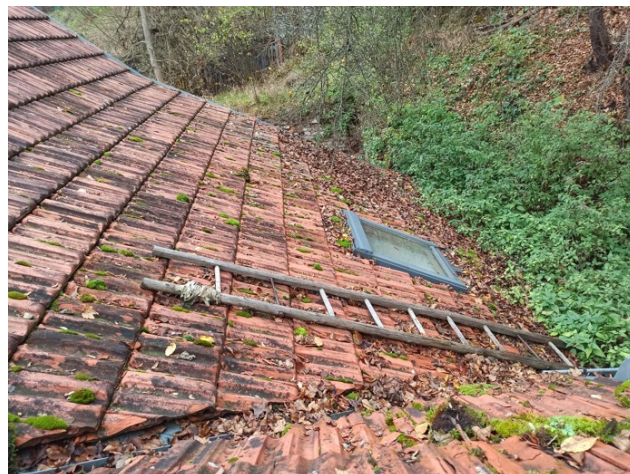
foto/14/ Pohled na znečištěnou střešní krytinu
