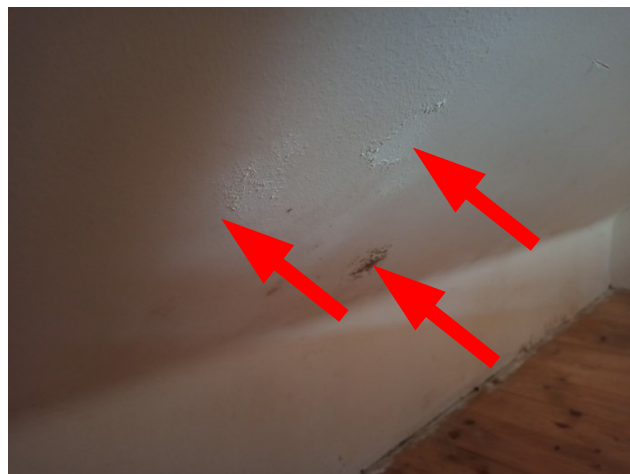
foto/28/ Pohled na SDK desku s vlhkostními projevy a napadením plísní z interiérové strany
